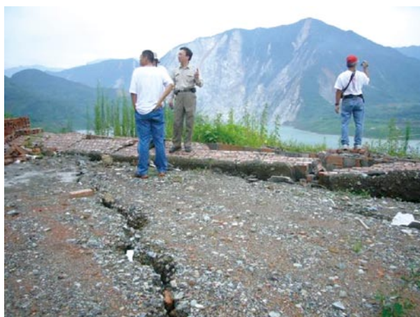
圖7 紫坪鋪水庫廟子坪附近岷江右岸受地震影響龜裂。
