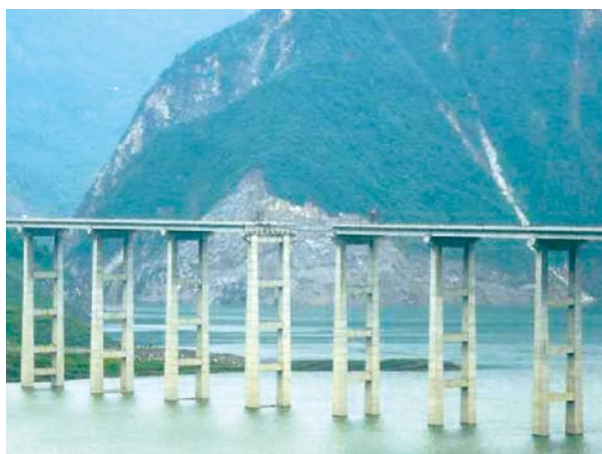
圖6 都汶高速公路跨紫坪鋪水庫廟子坪大橋因地震造成中間橋板斷落水庫。
