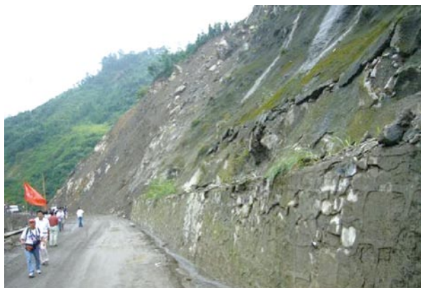
圖10 國道213線上邊坡採鋼絲鐵網水泥噴漿處理，與遠處兩相對照，已發揮噴漿處理之功效。但因地震導致部分隆起，與地面脫離，未來容易因雨水侵蝕造成整片鐵網噴漿下滑的次生災害。
