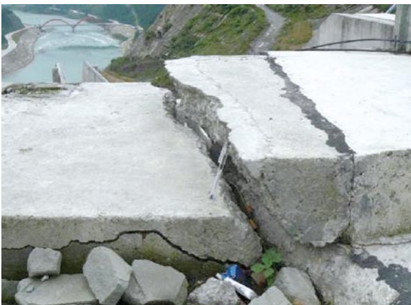
圖3 水庫壩頂受地震影響，照片左側相對右側陷落約15公分。
