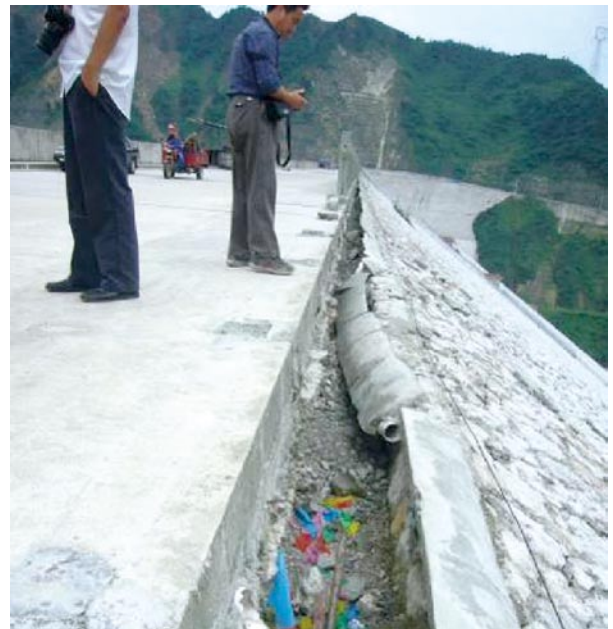
圖4 水庫壩頂外側護欄震落於下游背水坡面，大壩中央下陷約70公分，向下游面外移約30公分。
