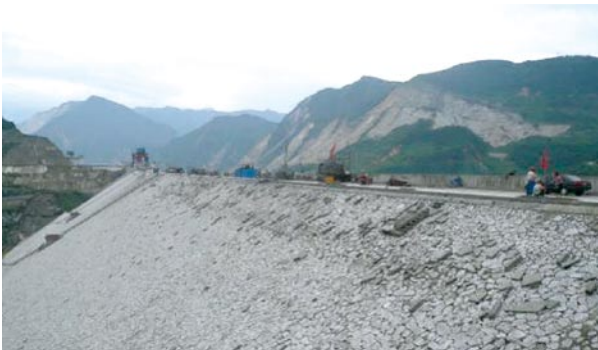
圖2 紫坪鋪水庫壩頂外側護欄因地震震落於下游背水坡面。
