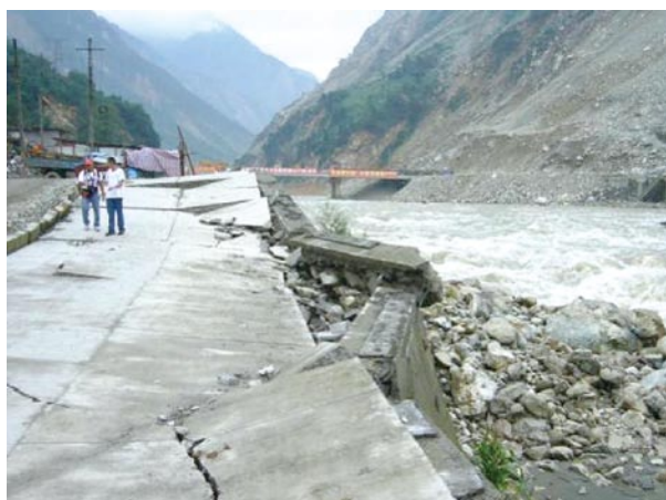
圖18 斷層經過處因擠壓造成護岸推擠歪斜。人站於斷層跡上，其後方抬升約2-3公尺。
