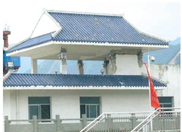
圖5 水庫壩頂房舍受地震剪力作用導致結構受損。
