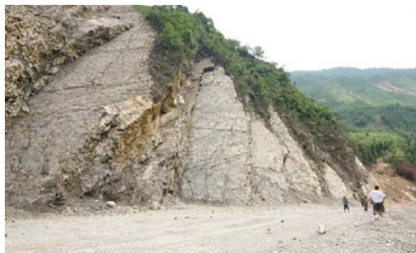
圖14 茶坪河肖家橋段河岸石灰岩之層理明顯，本區崩塌與地滑大多沿層理發生。
