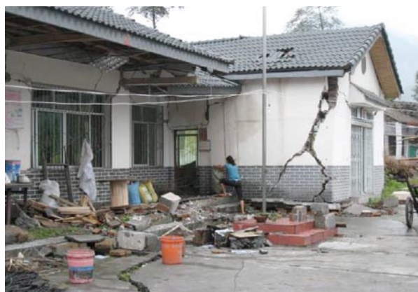
圖21 斷層通過附近造成地板龜裂與房屋嚴重受損。
