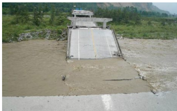
圖22 因地震力作用造成小魚洞大橋橋板陷落河床。
