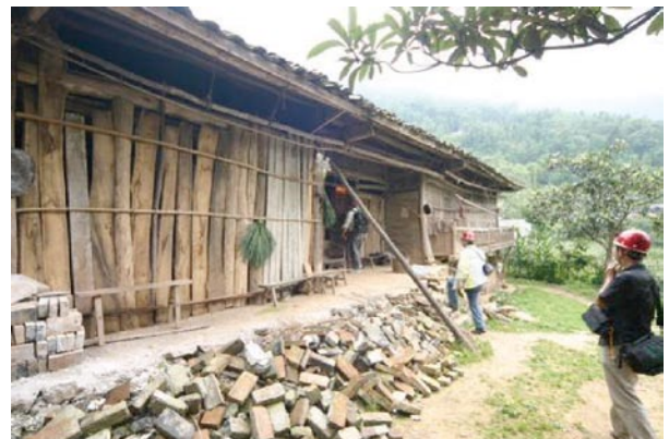
圖12 位於新北川中學上方景家山之木造房舍，屬柔性結構，雖歷經512汶川地震衝擊，但仍大致完整無損，其前方磚砌之圍牆則因地震而倒塌。
