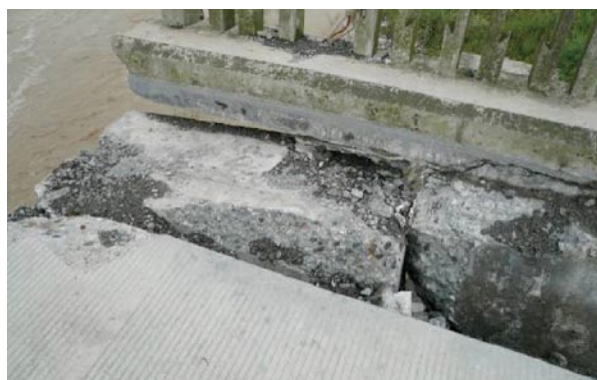
圖23 小魚洞大橋因地震力作用造成橋板分離。
