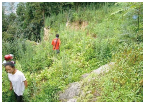
圖13 景家山崩塌（新北川中學後山）冠部所見之次級崩崖，高1~2公尺。
