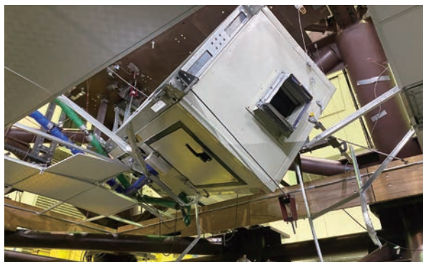
與日韓合作之實驗證實耐震不佳之懸吊設備易危害生命安全
